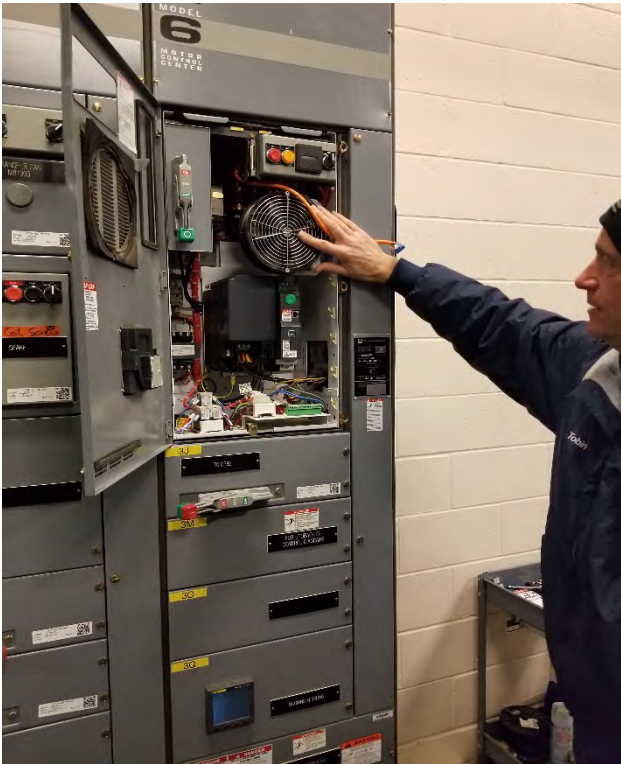
BNR Fan VFD Replacement
