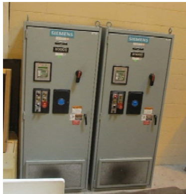
Odor Fan VFDs
