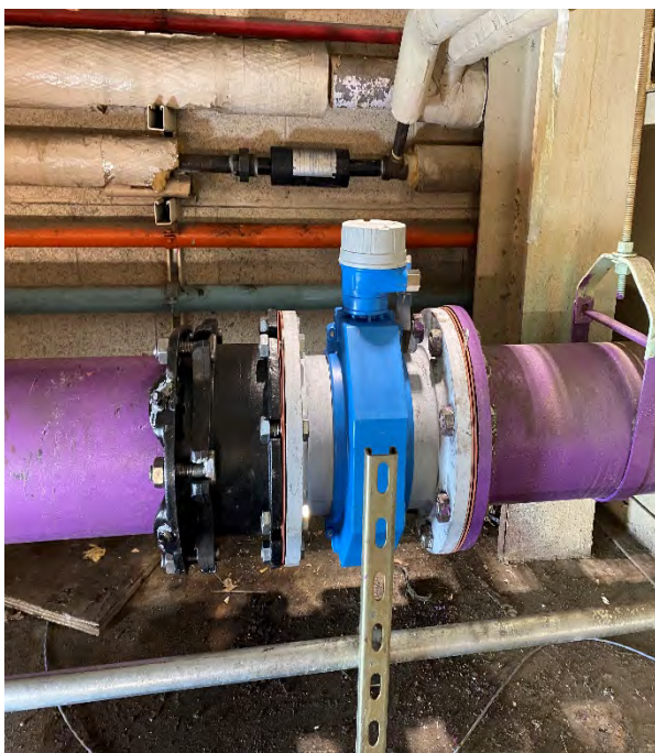
2 Water Mag Meter
