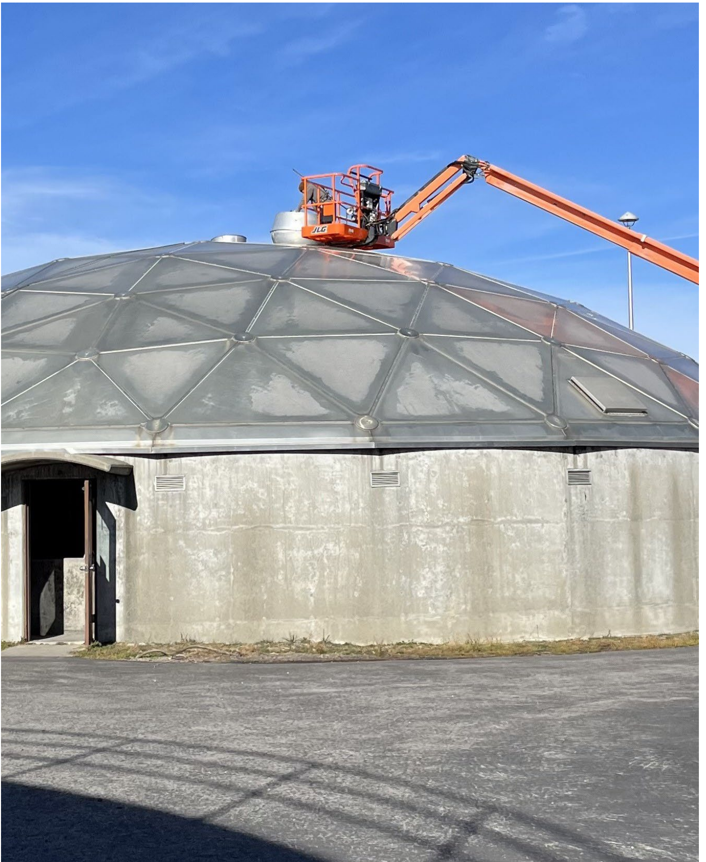
Primary #3 Fan Conduit
