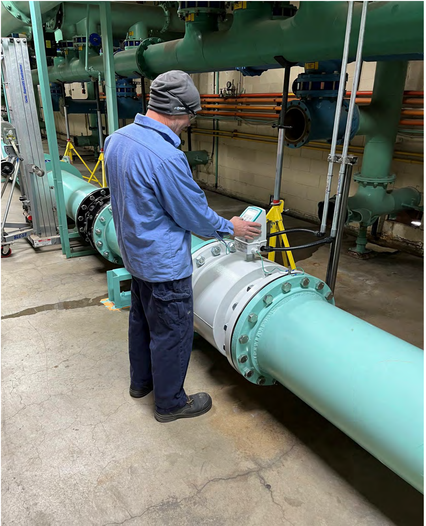
Final Effluent Flow Meter Startup
