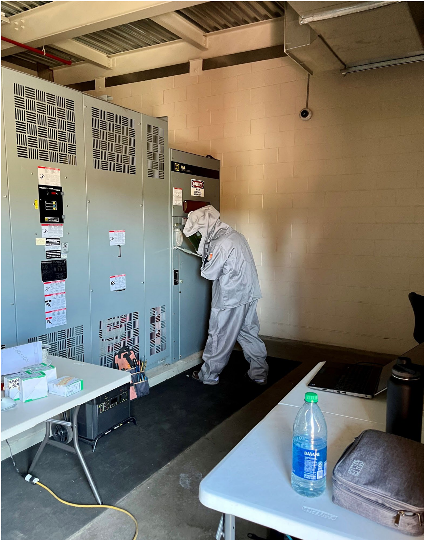
BNR Switchgear Main
